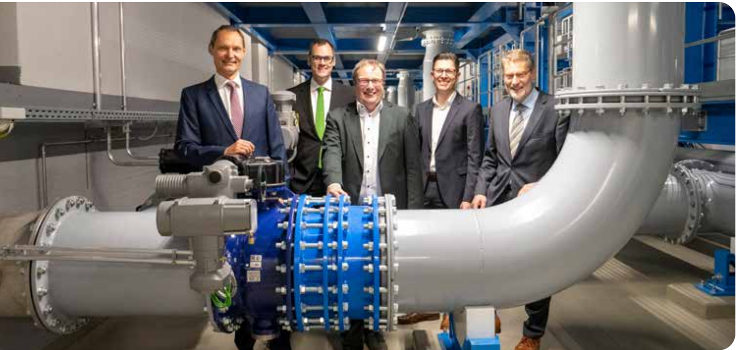
Die WWW-Geschäftsführer Bernd Heinz (links) und Dr. Bernhard Klocke (rechts), NRW-Umweltminister Oliver Krischer (Mitte) und die Gesellschafter Henning Deters (2.v.l. Gelsenwasser) und Matthias Klein-Lassek (3.vr. DEW21) bei der Inbetriebnahme der WAA Hengsen.
